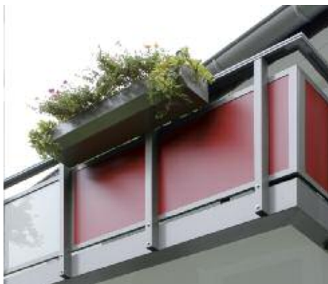
Wypełnienia balustrady; G & S die Balkonbauer, Ahlen (D)
